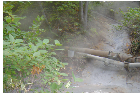
写真2. 大湯沼川との合流地点(図1 B)からみた上流部。引湯管が曲がっているのが分かる。
