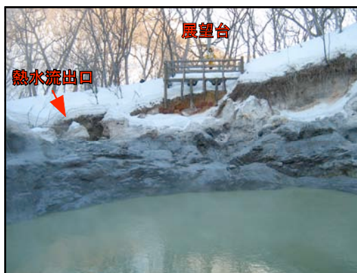
写真1. 崩壊により露出した展望台支柱。(2010年1月21日)
